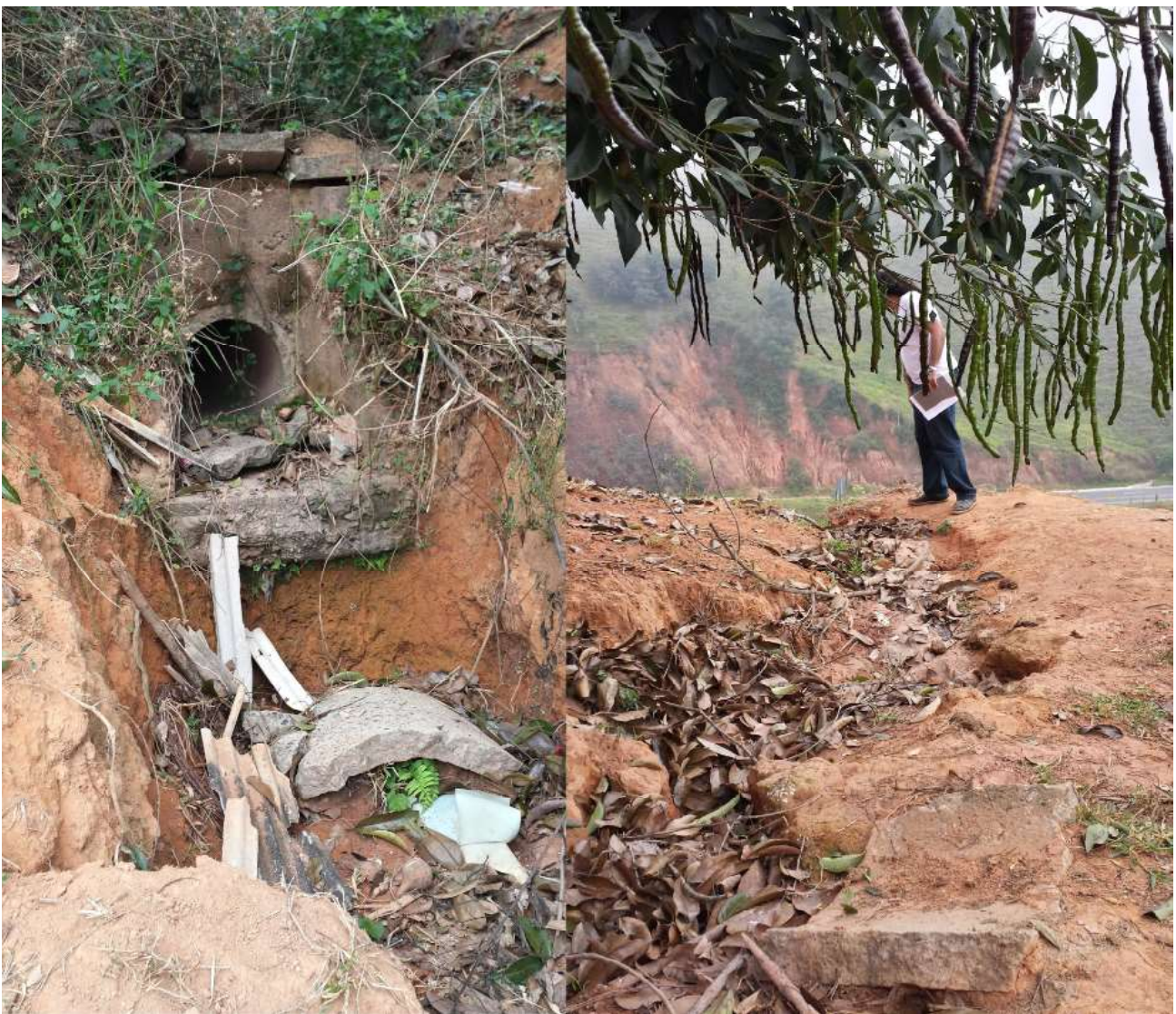
Figura 6 - Dispositivo de drenagem (bueiro) existente na rodovia, a dez metros da cabeceira da voçoroca.
