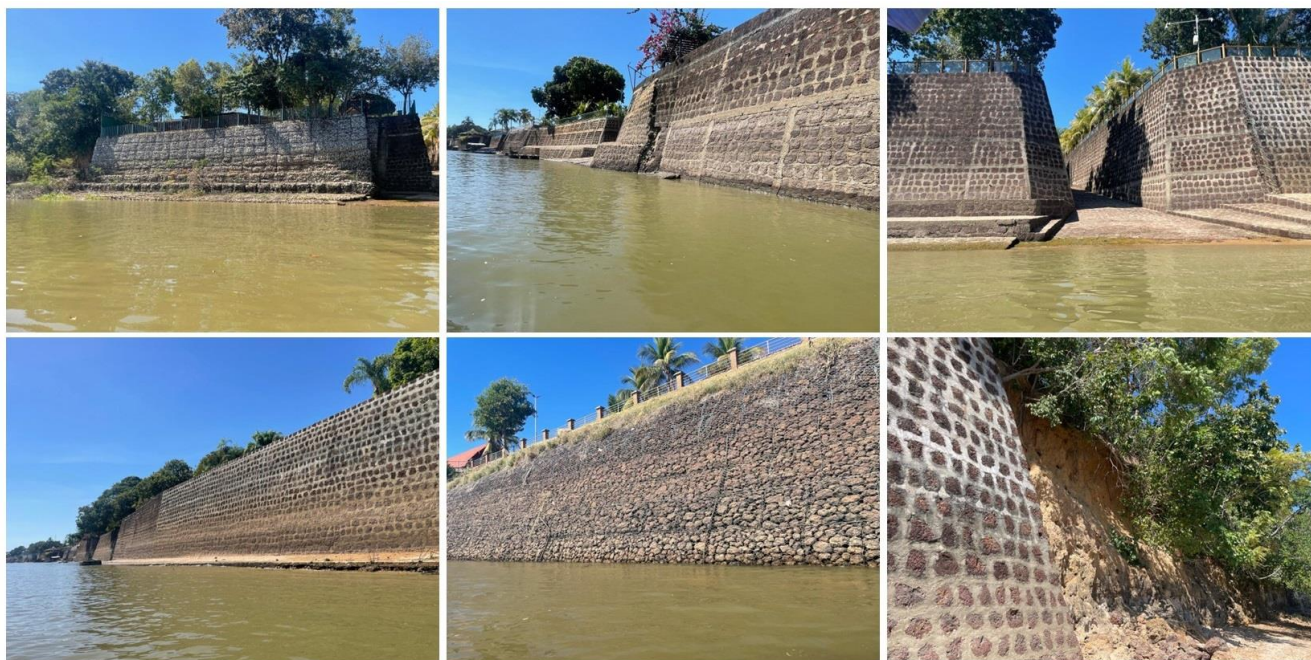
Figura 14. Estruturas de contenção na confluência dos rios Araguaia e Vermelho, da margem direita do rio Vermelho até jusante da confluência. Fonte: Os/as autores/as, 2025.
