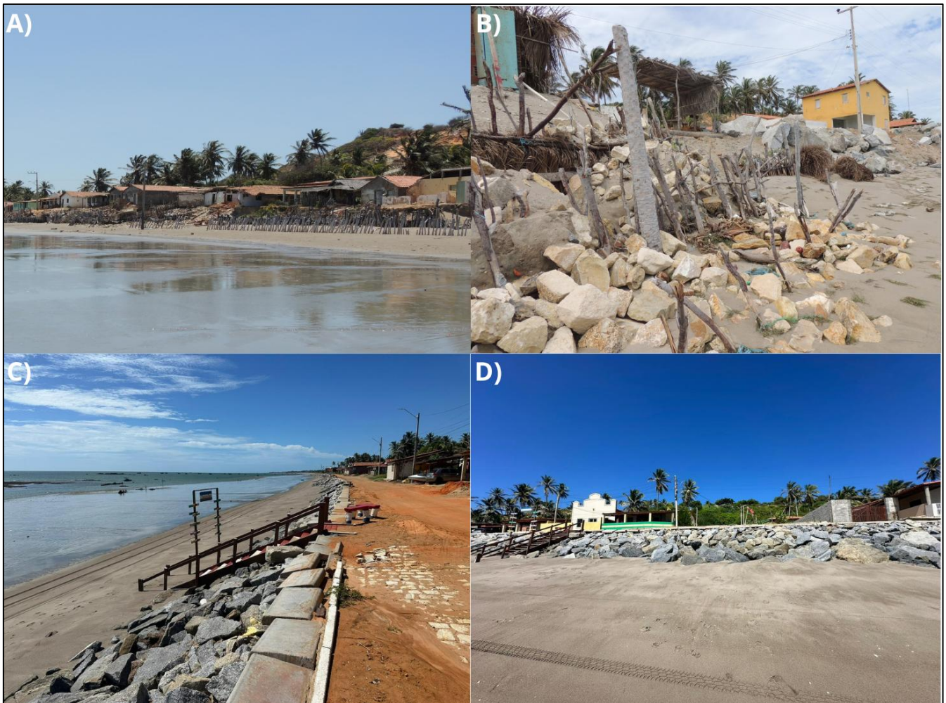
Figura 17. Medidas de contenção utilizadas para conter o recuo da Linha de Costa e atenuar a ação das marés. A e B) Alinhamento de estacas de madeira, blocos de calcário e sacos de areia – 2015; C e D) Utilização no mesmo local de estrutura rígida no formato de enrocamento utilizado para conter o recuo da Linha de Costa – 2024.
