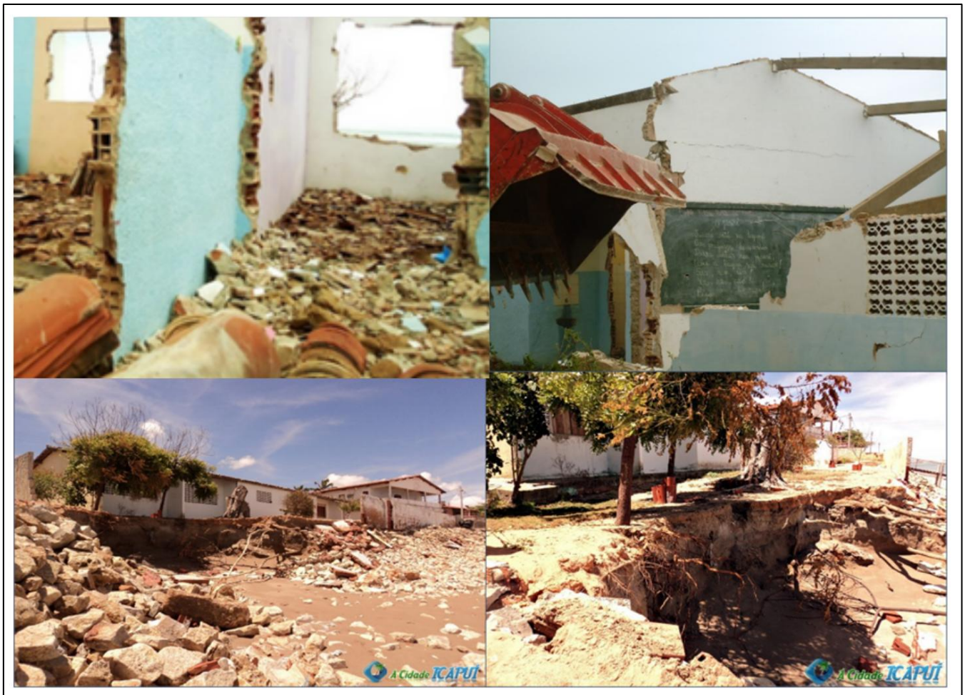
Figura 20. Danos causados erosão costeira ao patrimônio edificado na Praia da Barrinha entre os anos de 2002 e 2010. Fonte: Blog “A Cidade Icapuí”.
