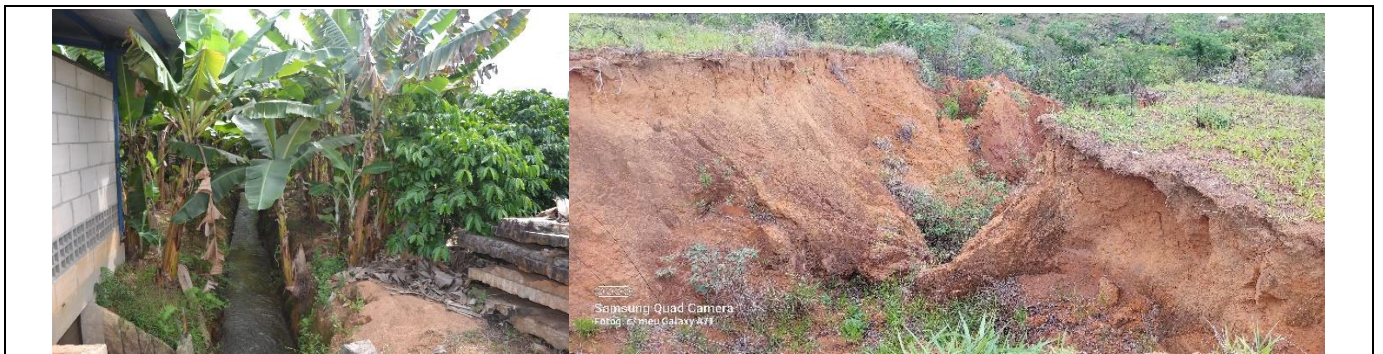
Figura 8. Canalização e voçoroca presente no setor 4, do rio Duas Bocas. Fonte: dos autores.
