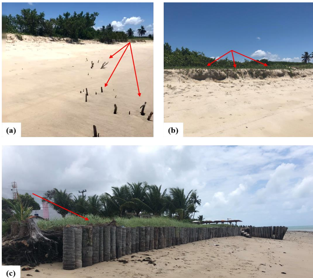
Figura 6. (a) representa a exposição, no estirâncio, de raízes de plantas erodidas pela ação de ondas; (b) exhibe a atuação de processos erosivos na base da vegetação de restinga, danificando-as, ambas localizadas no trecho protegido sob influência do Rio Mamucabas e (c) mostra a artificialização da LC por obras rígidas, o parcelamento e supressão da vegetação de restingas, no segundo pontal, no trecho protegido urbanizado.
