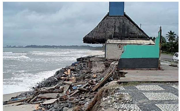
Figura 7 – Desmoronamento de parte de um quiosque pela ação erosiva das ondas na praia de São Miguel.
