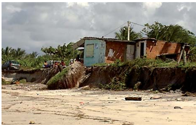
Figura 8 – Residência em iminência de destruição pela ação erosiva das ondas na praia de São Miguel.
