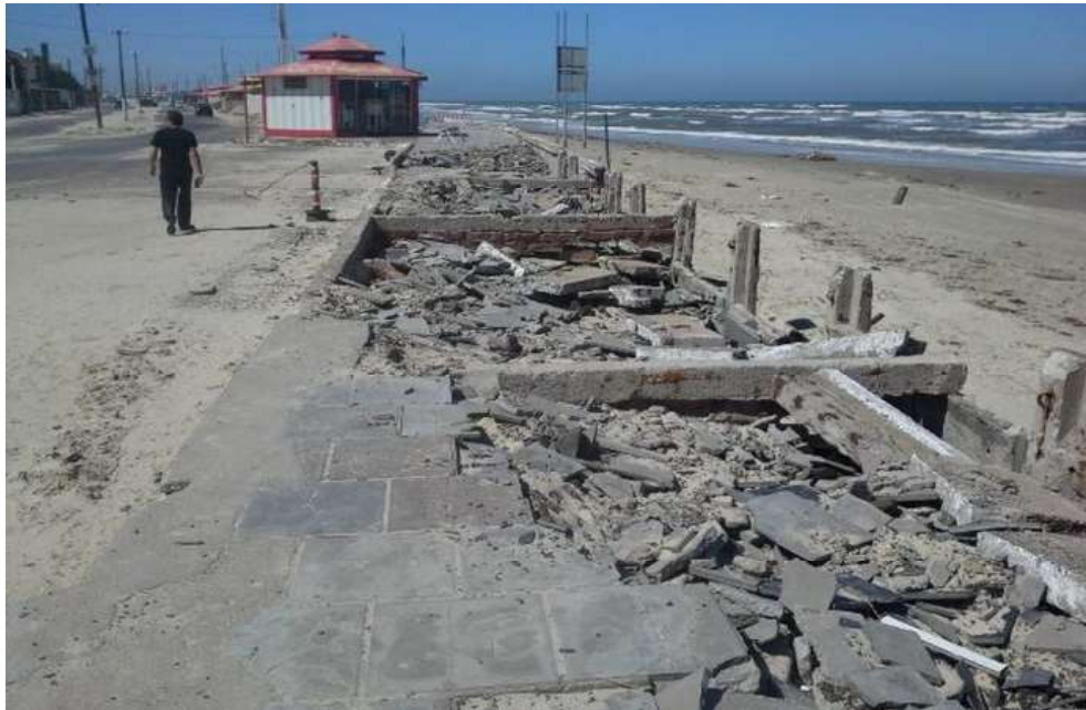
Figura 17 - Calçadão e mureta de contenção parcialmente destruídos em Balneário Imbé.
