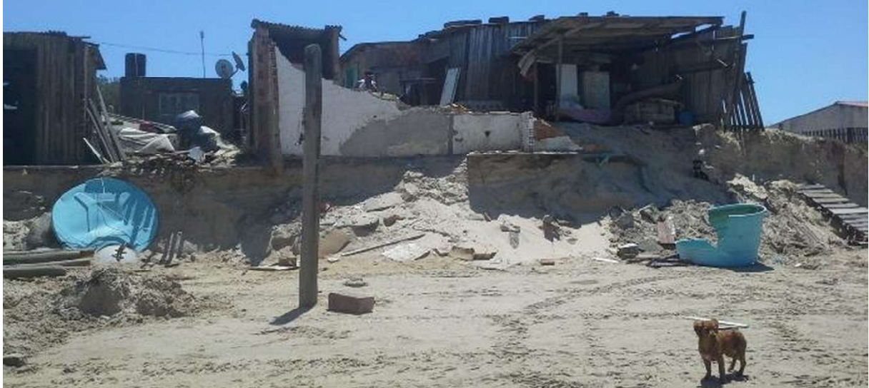
Figura 20 - Danos em edificações de madeira no balneário Zona A - Cidreira.
