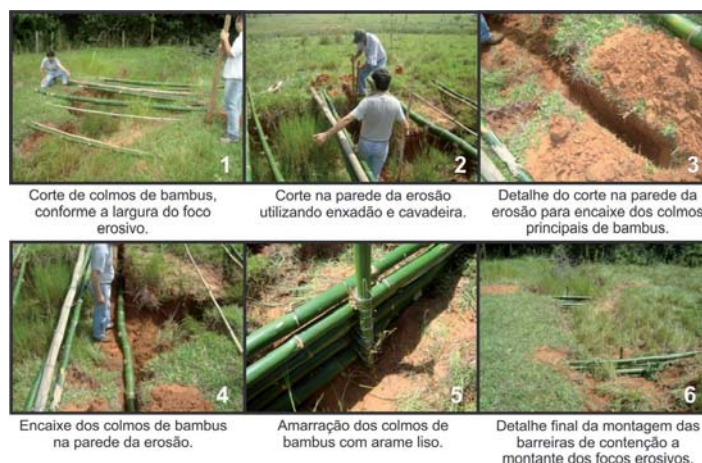
Figura 4 – Etapa de montagem das barreiras de contenção. Foto: Dos autores, trabalho de campo, março de 2012.
